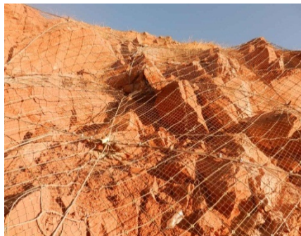
Dislocation de blocs de gré sous le grillage
