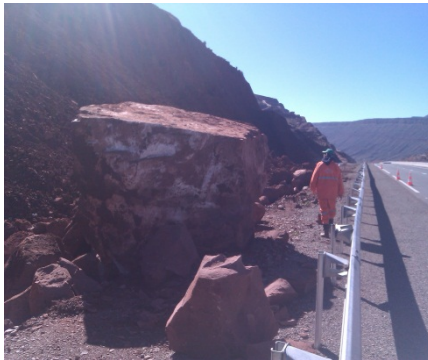
Fin décembre 2010 : Chute d'un gros bloc au niveau de la zone d'extrême Nord (petit D15) ;
