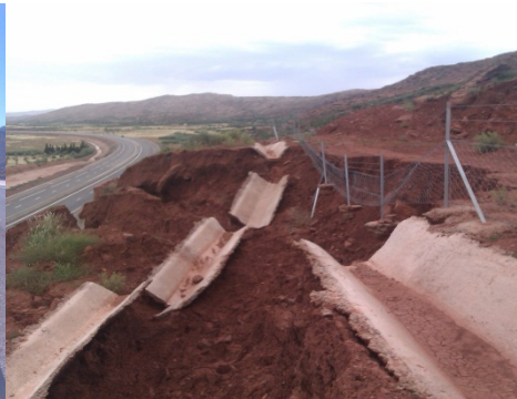
Tête du décollement : Clôture en porte à faux
