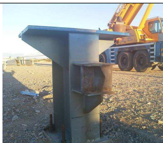
Figure 53 - Ergot de vérinage déformé
