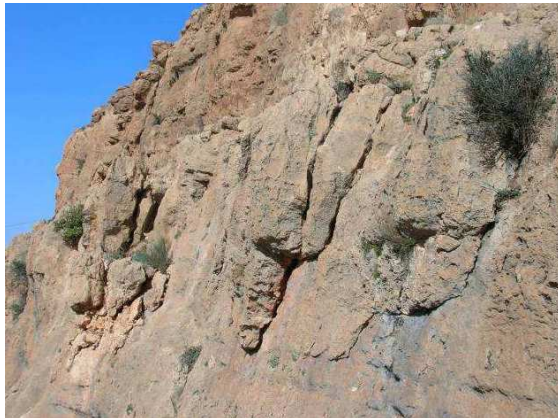
Photo 11 : Blocs instables surplombant la tête Sud
