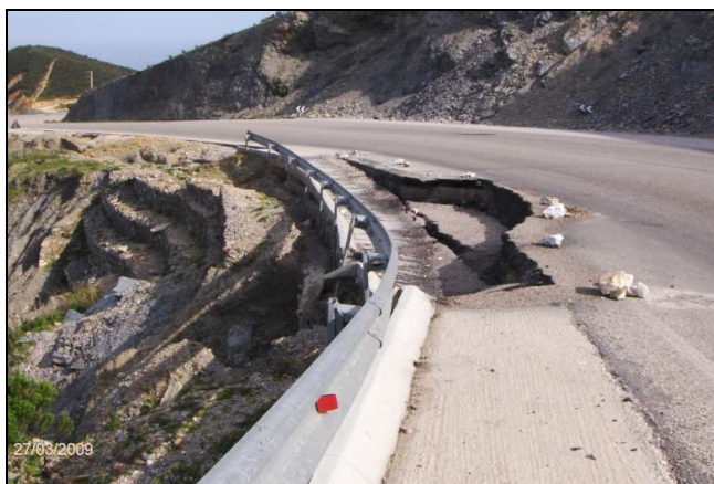
Dégradation du remblai RN16
