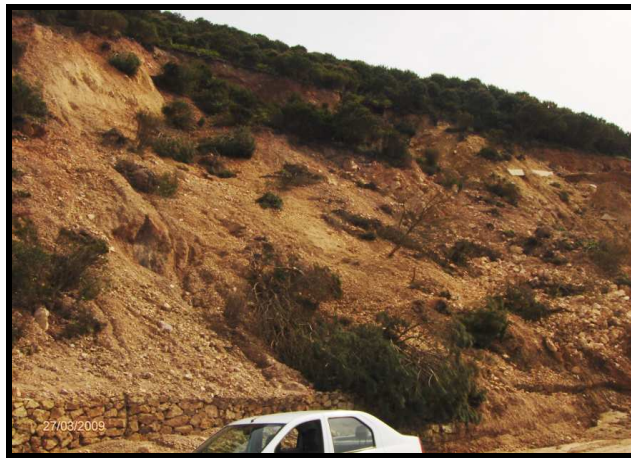
Dégradation de déblai RN16
