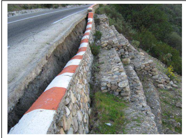
RN13 PK : 67+100 (murs en surcharge)
