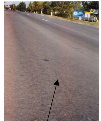
Zone témoin sans grille de 100 m environ. En 2005, les fissures sont remontées.
