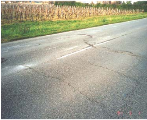
Chaussée en grave hydraulique + enrobé, fissurée transversalement avec fatigue structurelle
