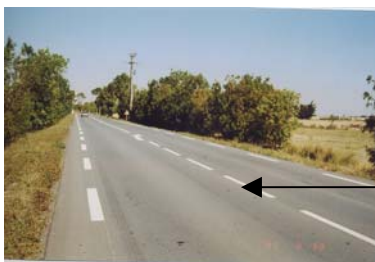
Zone renforcée en Rotaflex. En 2005 aucune fissure n'est remontée
