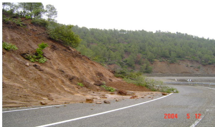
(photo 5) : éboulis au niveau de la RN8 à Taounate
