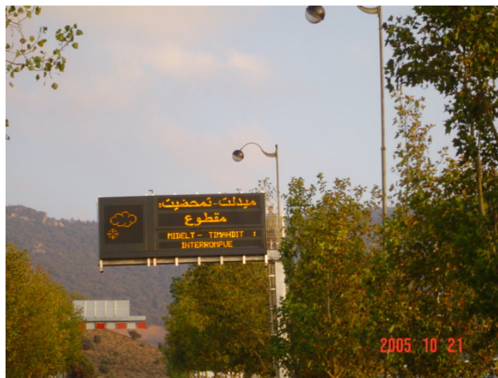
(photo 3) : panneau à messages variables sur la RN13 à Azrou
