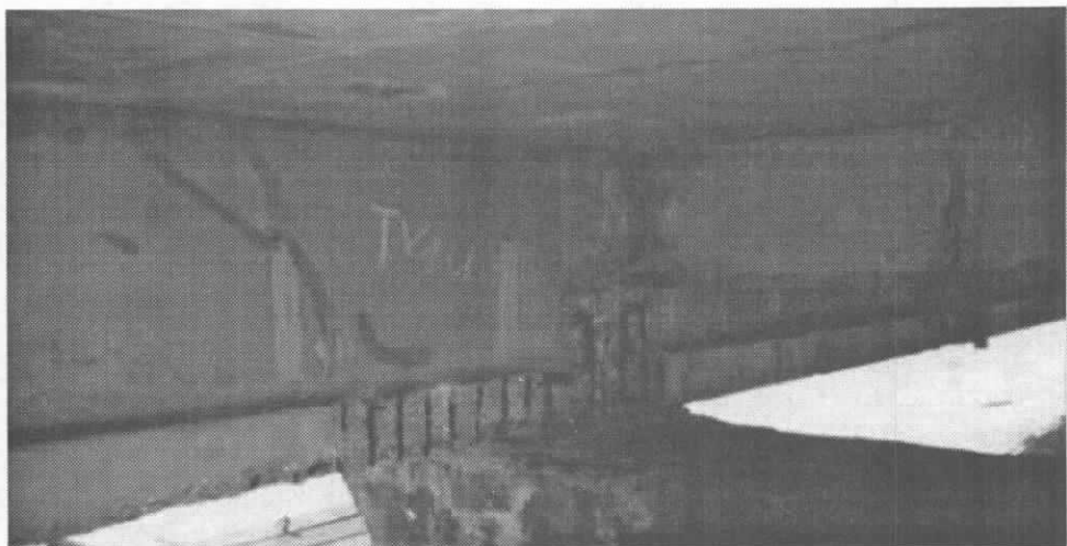
Dégradation des talons des poutres et arrêtes des chevêtres
