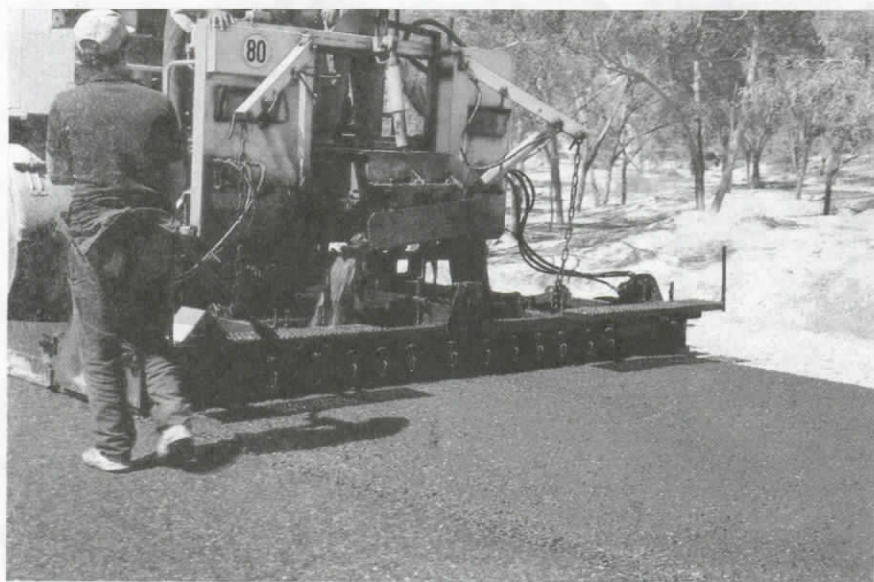
Ecoulement de l'E.C.F. dans le spreader.
