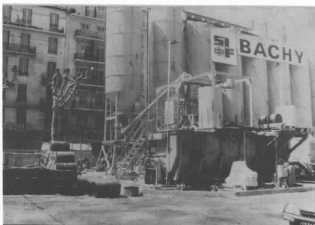
Type de centrale de préparation et de traitement de boue pour un chantier de fondations important. (Document SIF BACHY)
