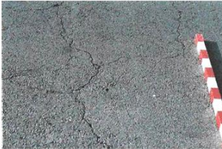
Fig n°3 : Dégradation superficielle caractéristique de la fissuration par le haut des couches de surface
