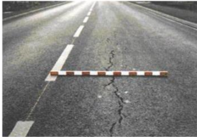
Fig. n°4 : Dégradation structurelle caractérisant l'usure des couches d'assise Traduite par une fissure longitudinale unique
