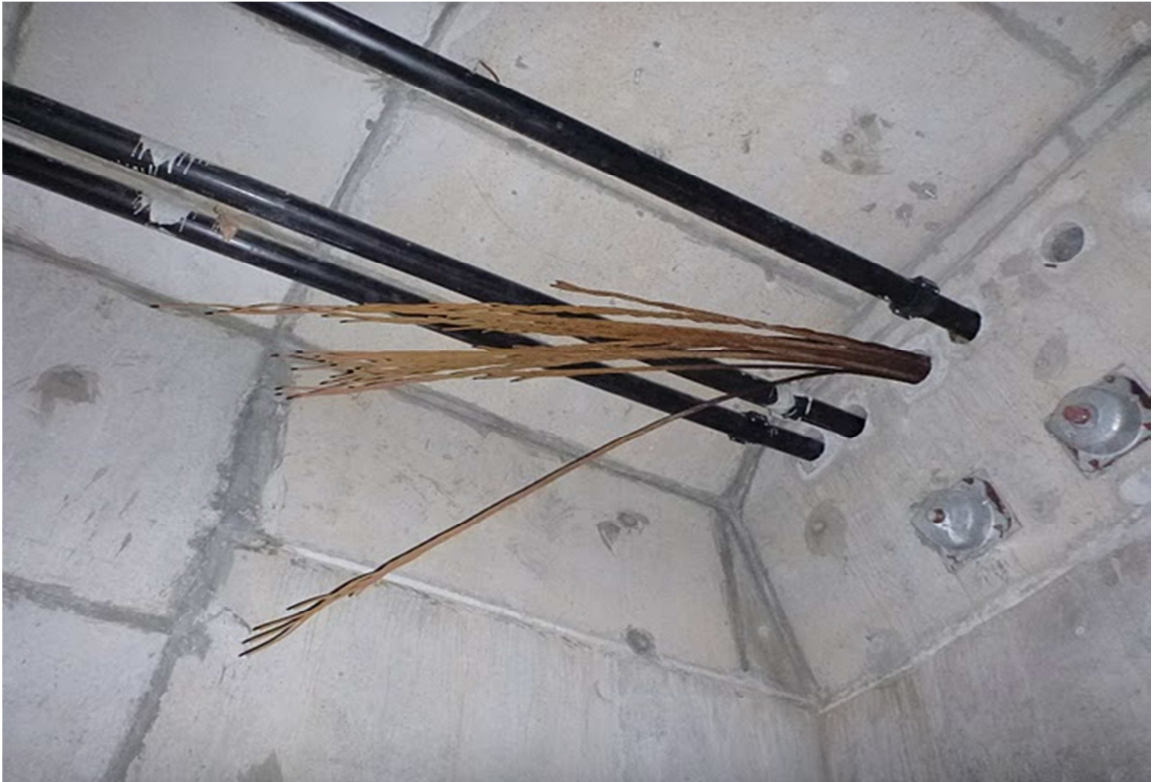
Rupture d'un câble de précontrainte intérieure (Viaduc Oum Rbii – Autoroute Casablanca – El Jadida)
