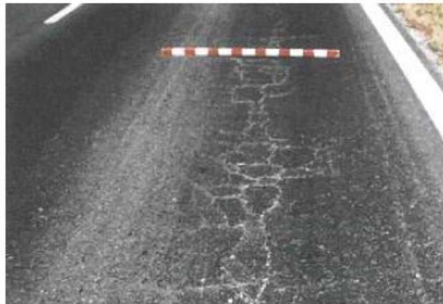
Fig n°5 : Dégradation structurelle caractérisant l'usure des couches d'assise Traduite par une fissure longitudinale ramifiée
