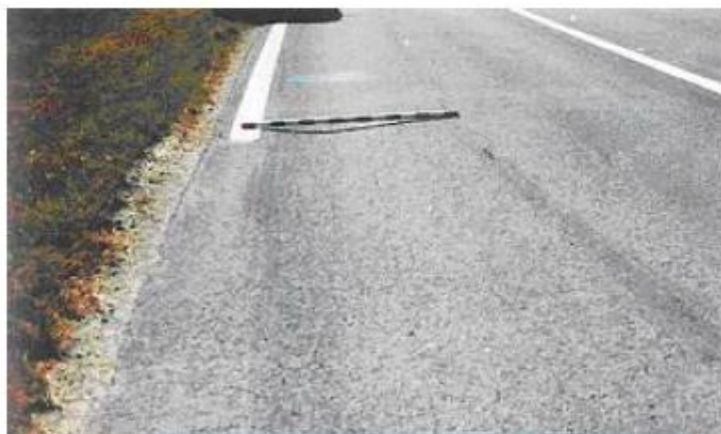
Fig. n°2 : Dégradation superficielle caractéristique d'un orniérage des couches de surface
