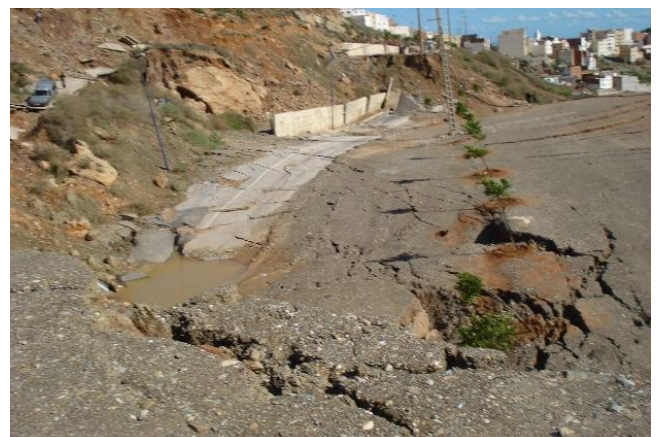
Effondrement d'un versant après plusieurs années de stabilité
