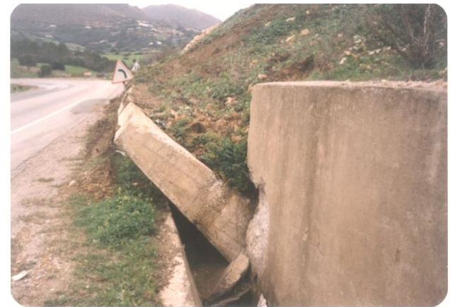
Effondrement de mur de soutènement après plusieurs années
