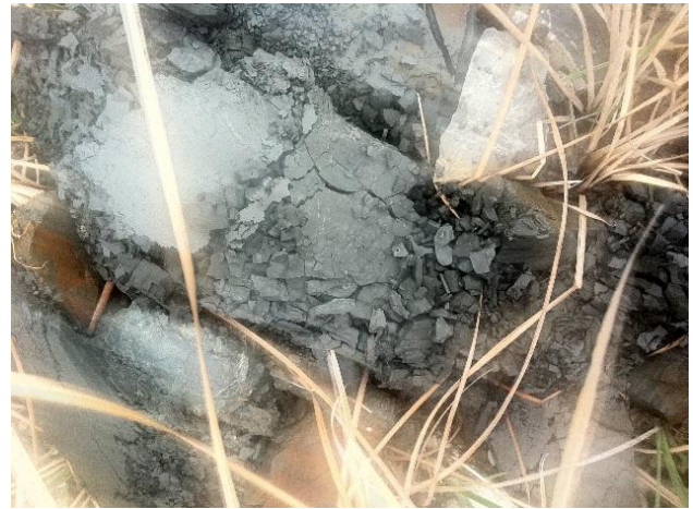
Silite en cours d'effrètement
